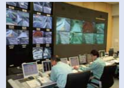
施設制御センター
