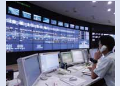
交通管制センター
